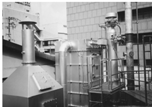
排ガス処理装置
