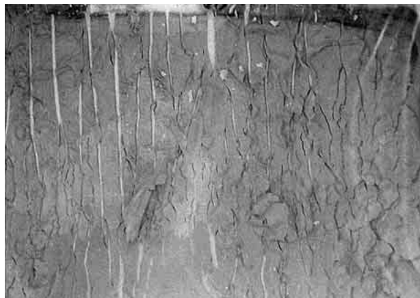
写真1 EPMA製ゴムホース内面が銅イオンと水道水の残留塩素の2成分の相乗効果による激しい劣化が生じている様子
